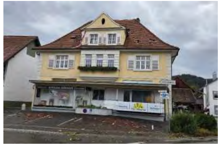
Herabgefallene Ziegel am ehemaligen Kaufhaus Grundler
