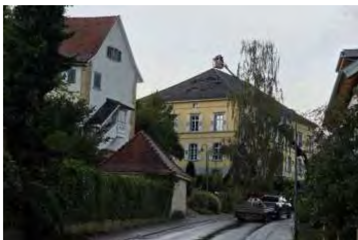
Kaputte Fensterläden am Rathaus, Wassereinbruch und offenes Dach
