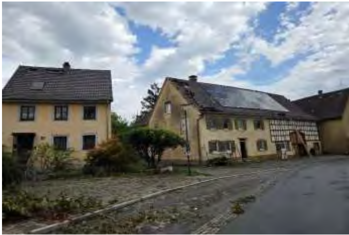
Teilweise abgedeckte Dächer in der Ledergasse
