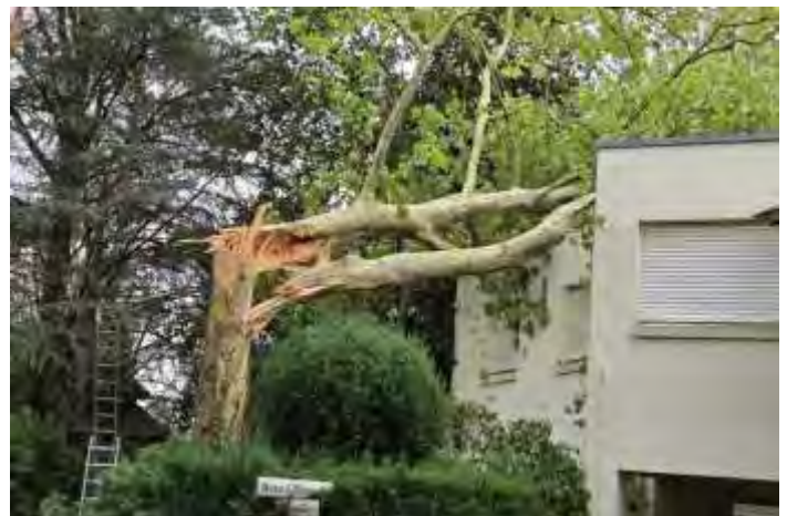
Durchschlagenes Dach von Baum bei Gartenmanufaktur Siegwarth
