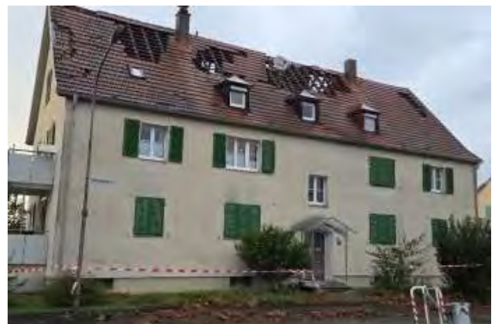
Zollhaus nach dem Sturm nicht mehr bewohnbar
