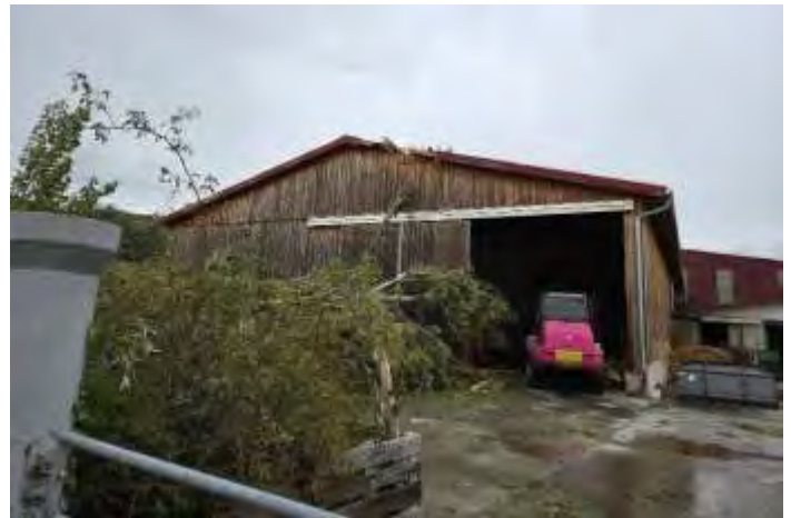
Zerstörtes Dach durch umgestürzten Baum am Reitstall
