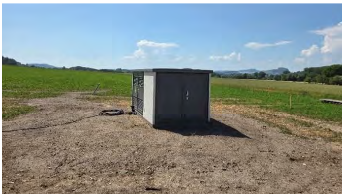
Trafostation am Zeltlager
