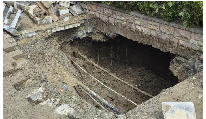
Wasserrohrbruch in der Ledergasse
