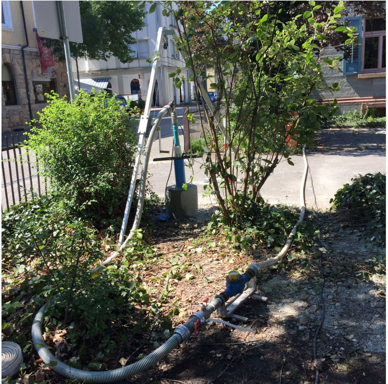
Abbildung 4: Pumpversuch in Messstelle GWM1 (oberflurig ausgebaut) und Einleitungsstelle Hausanschlusschacht des städt. Mischwasserkanals auf der gegenüberliegenden Seite der Hofeinfahrt des Flurstücks Nr. 6115.
