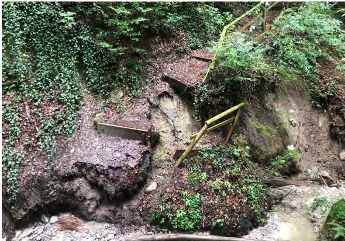
Weggebrochene Geländer am Auf- und Abstieg zur Bohlinger Schlucht
